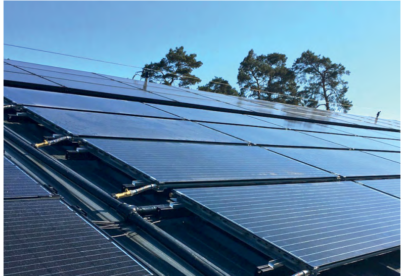
80 m2 SOLINK-Anlage in Lütlich (BE)
