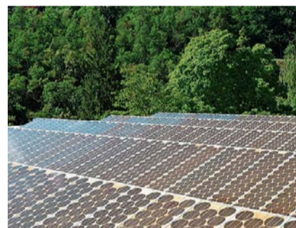
Baujahr 1982: Anlage in Canobbio (TI).
